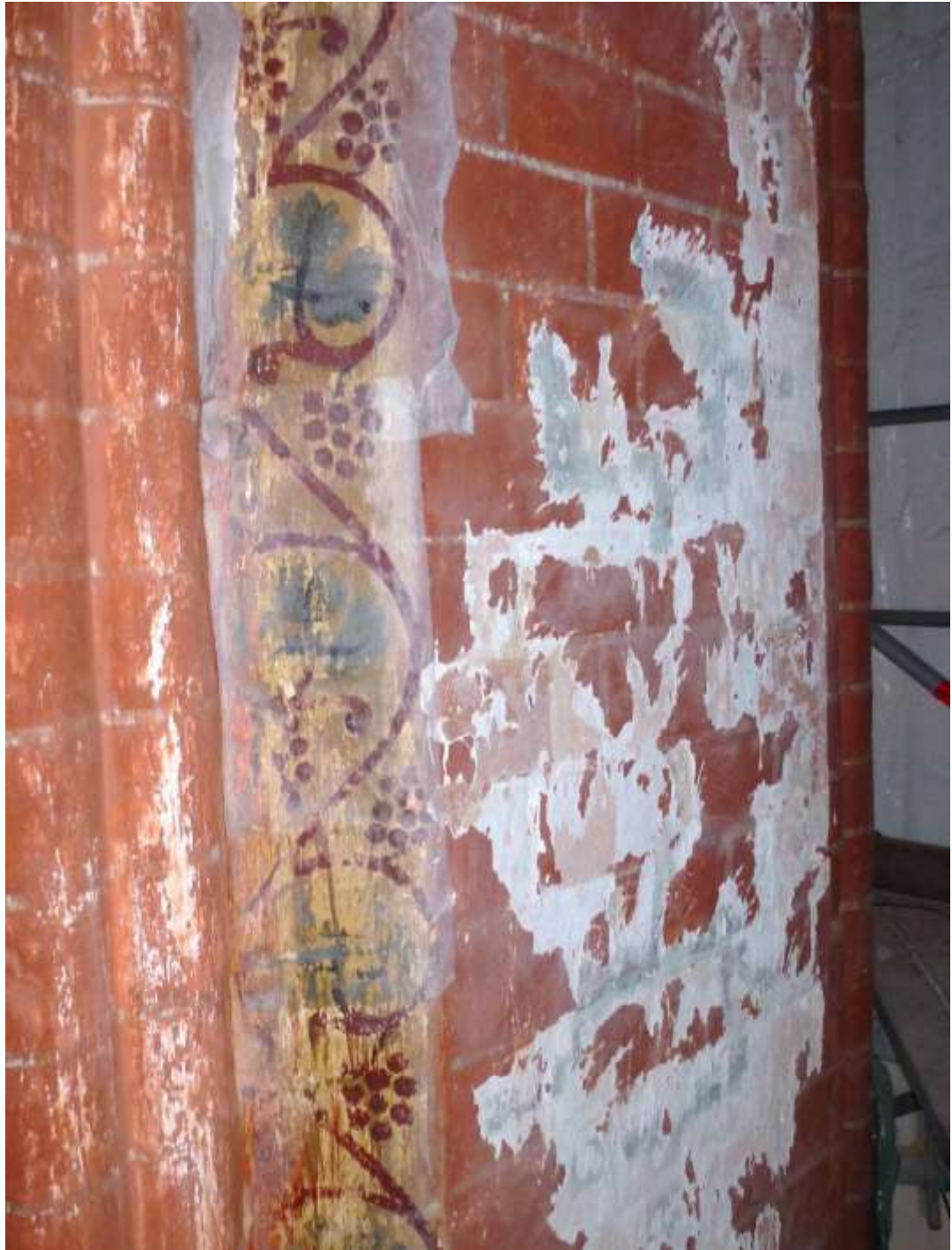
Foto 13 Fragmente der Erstfassung auf dem Pfeiler E2 - Teppichmuster
