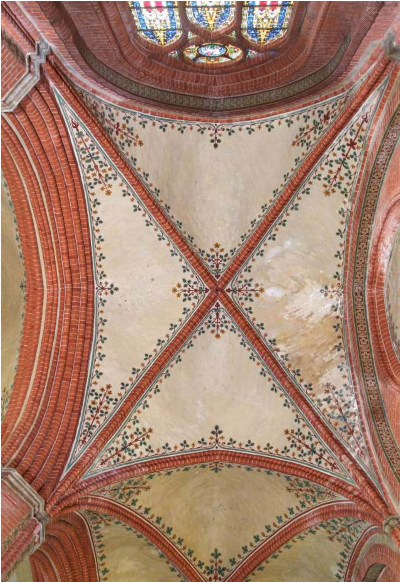
Foto 50 Gewölbe des Joches N1 vor der Restaurierung
