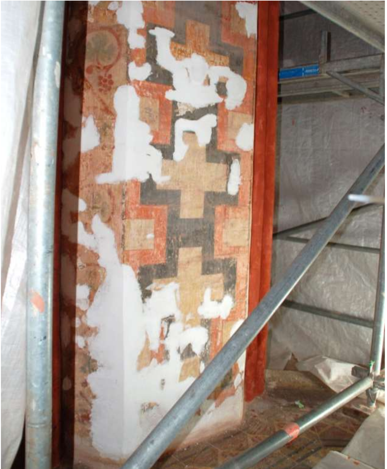
Foto 36 Kittungen im Bereich der Stützen
