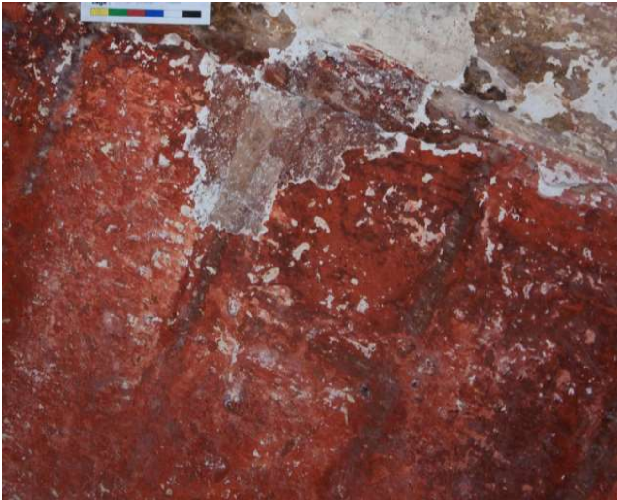
Foto 5 Befund der Erstfassung am östlichen Schildbogen des Joches N1
