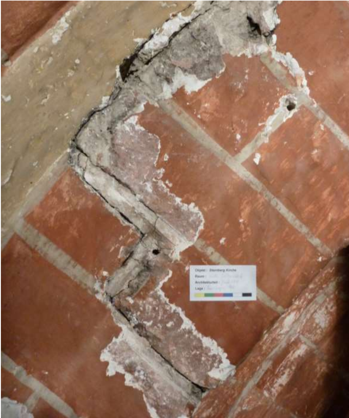
Foto 3 Befund der Erstfassung am östlichen Schildbogen des Joches N1
