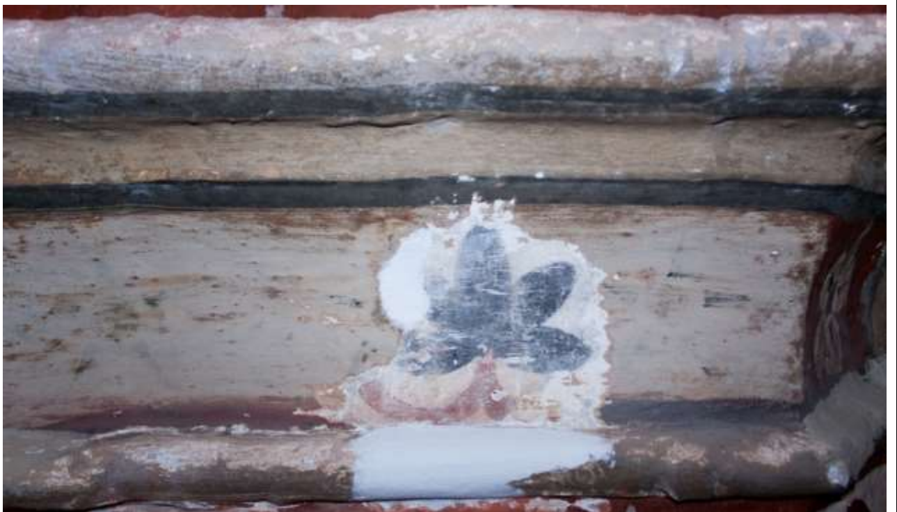
Fotos 19 und 20 Originalbefunde auf den Kapitellen
